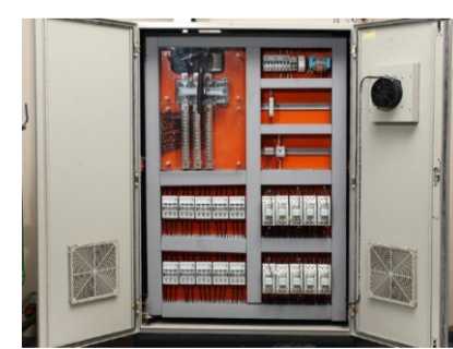
QGBT (Quadro Geral)
