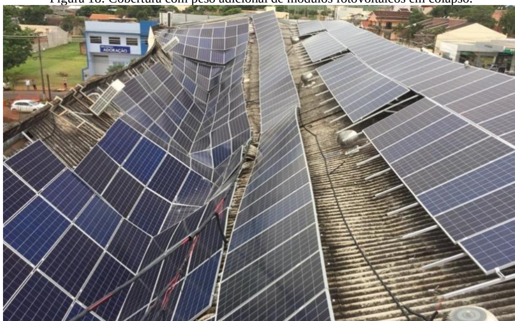
Figura 18: Cobertura com peso adicional de módulos fotovoltaicos em colapso.
