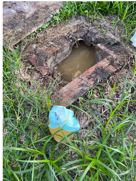
Figura 8: Esgoto ala UTI.
