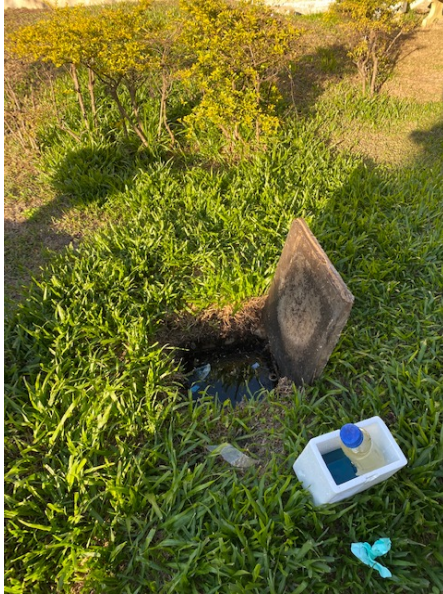
Figura 7: Esgoto Ala Internados.
